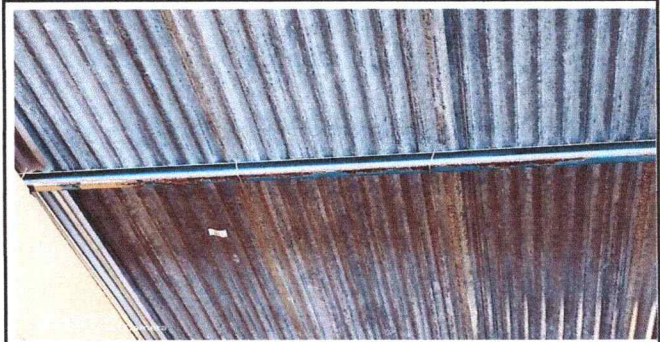
Foto 2: se Observa el deterioro de la estructura modulo 1
