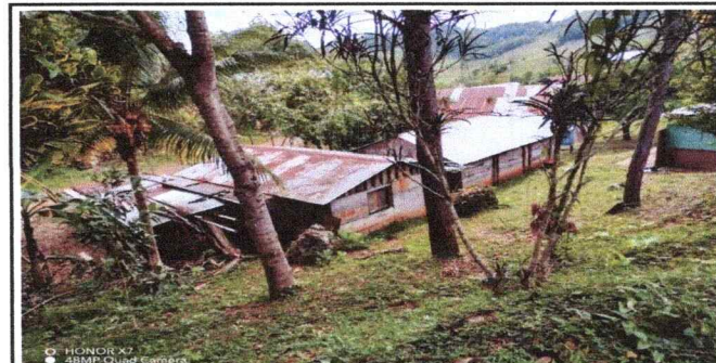
Foto 6: Se Observa el deterioro del techo de la cocina
