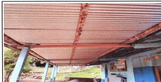
Foto 5: Se observa el deterioro de la estructura del modulo 1
